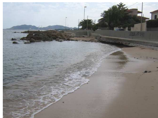
Frutti d'Oro via del Parco 2 - erosione alla base dei manufatti
