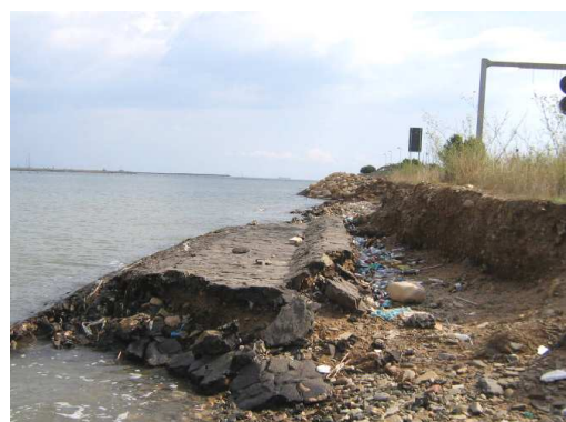
Ponte della Scafa - erosione
