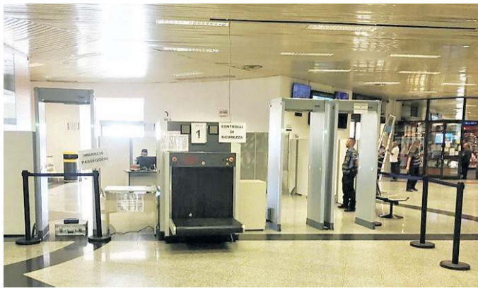
Gli impianti dei controlli di sicurezza nella stazione marittima
