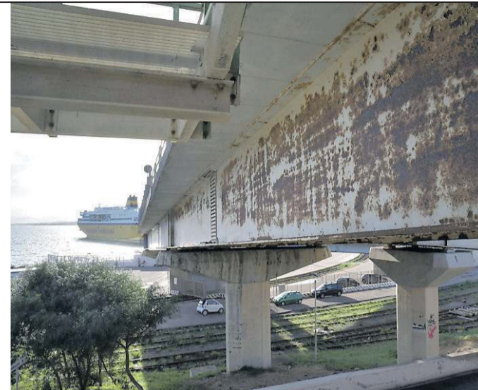
Un dettaglio del ponte con le parti di ferro aggredite dalla ruggine
